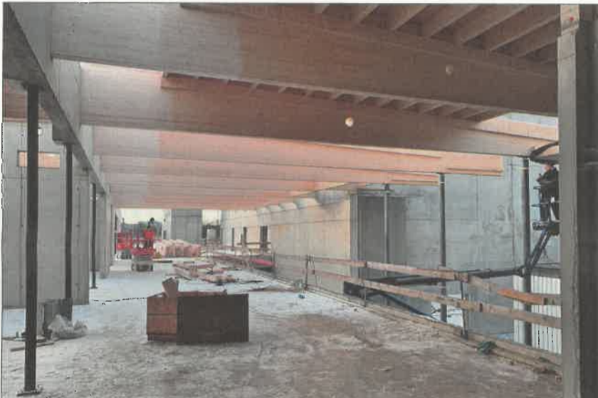
BSH-Satteldachbinder in der „Rue Intérieure“ mit eingefügter Pfettenlage und OSB-Beplankung als aussteifende Dachscheibe. Foto: Merz Kley Partner
