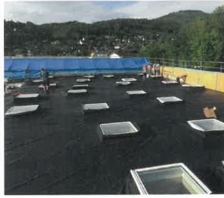
Die vorkonfektionierte EPDM-Dachplane ist ausgelegt und wird mit Kontaktkleber an den Aufsatzkränzen befestigt
